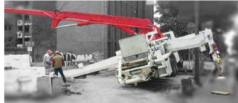
Wenn der Boden einbricht entstehen erhebliche Gefahren und Kosten.
